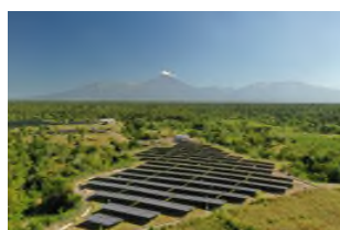
พลังงานแสงอาทิตย์ ติดตั้งบนพื้นดิน
